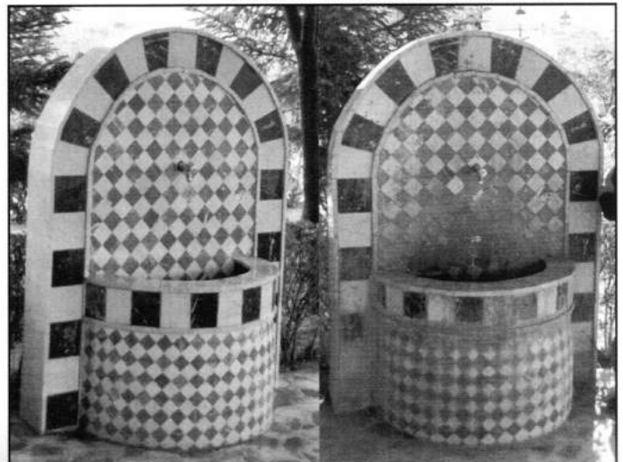
Fíjense el lavado que le hicieron a la fuente del Parque de Santa Catalina
